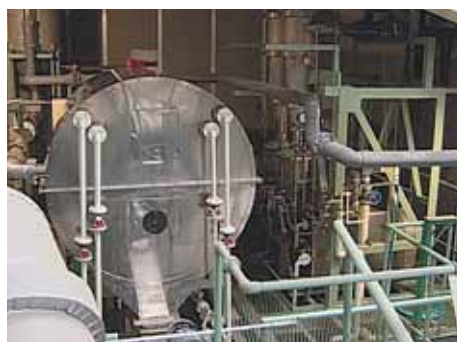
▲SR式沈砂除去装置
