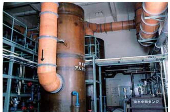
▲水洗・薬液洗浄脱臭装置
