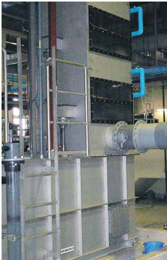
▲生物脱臭装置
