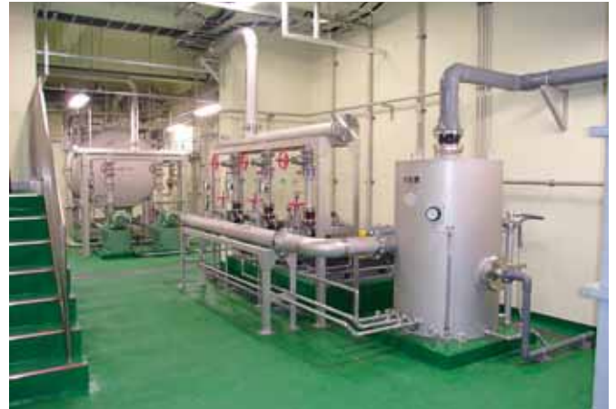
▲真空ステーション
