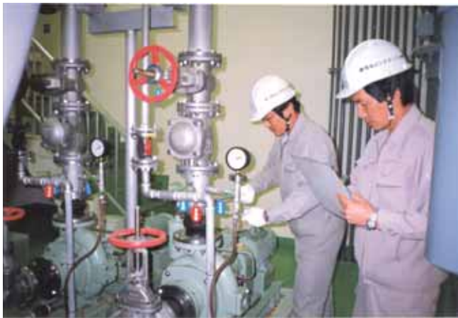
▲ステーション機器点検
